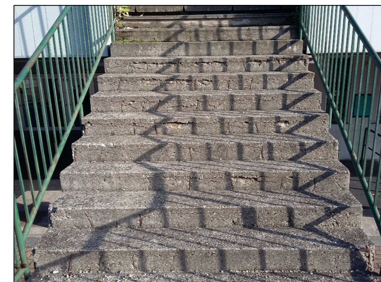
SCALA DI SICUREZZA "B" (SX) - Gradini superiori
