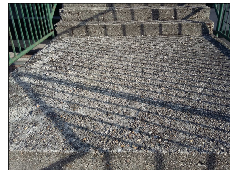
SCALA DI SICUREZZA "B" (SX) - Pianerottolo intermedio
