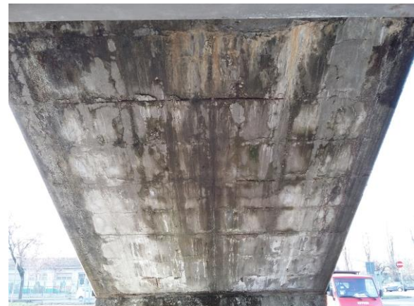
Mancanza di copriferro e ferri di armatura all'intradosso della soletta a sbalzo delle scale
