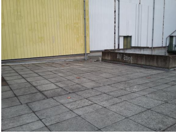
Pavimentazione sopraelevata in piastrelloni
