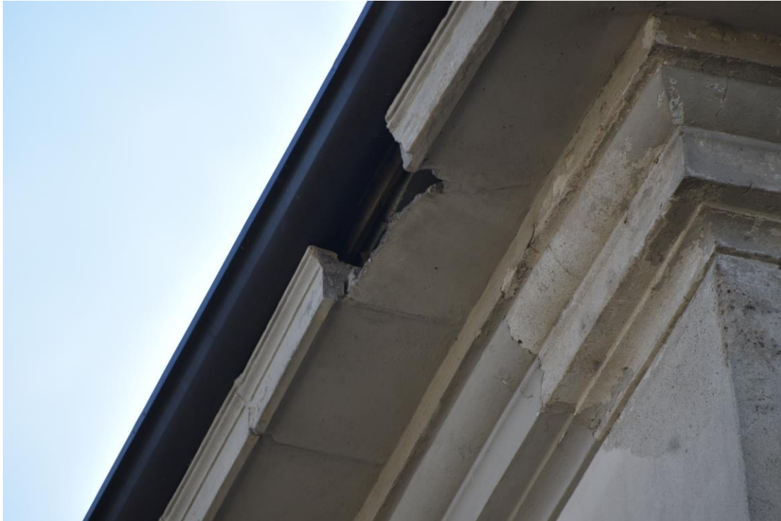
Figura 14 - gronda cementizia da consolidare
