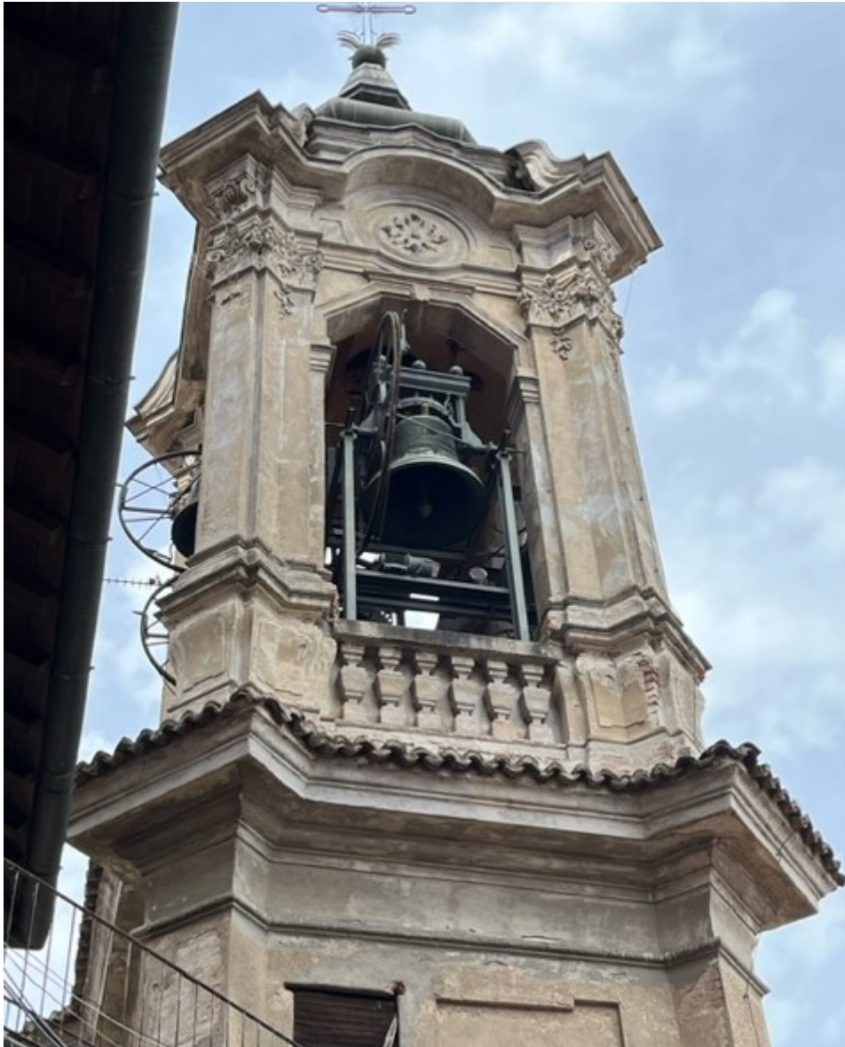
Fig. 6 -Vista del prospetto sud del campanile, da cui emerge la dominante materica dell'intonaco.
