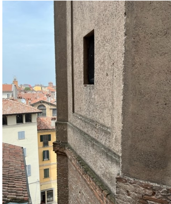
Fotografia n. 9 Dettaglio dell'intonaco privo ormai della finitura per dilavamento
