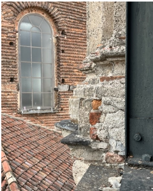
Fotografia n. 8 Dettaglio distacchi di intonaco livello cella campanaria
