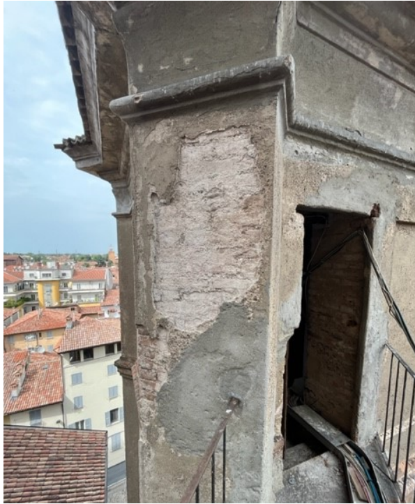
Fotografia n. 7 Fenomeni di distacco di porzioni significative di intonaco.
