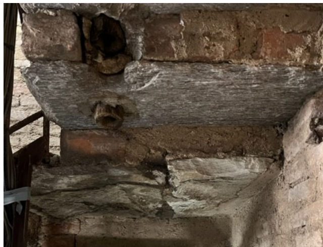
Fotografia n. 14 Vista interna: pedate in pietra fessurate
