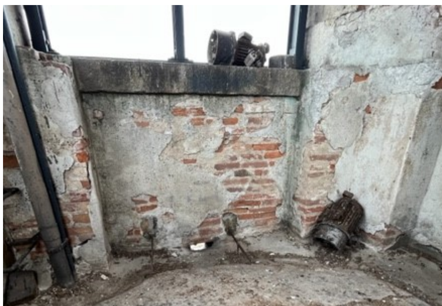
Fotografia n. 10 Dettaglio dell'intonaco distaccato fino al vivo della muratura
