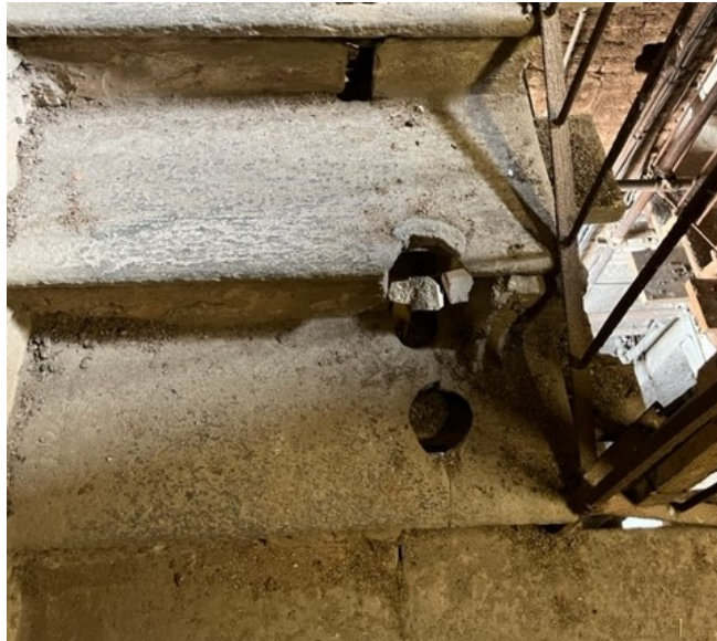
Fotografia n. 13 Vista interna: dettaglio pedate in pietra con fori o rotture
